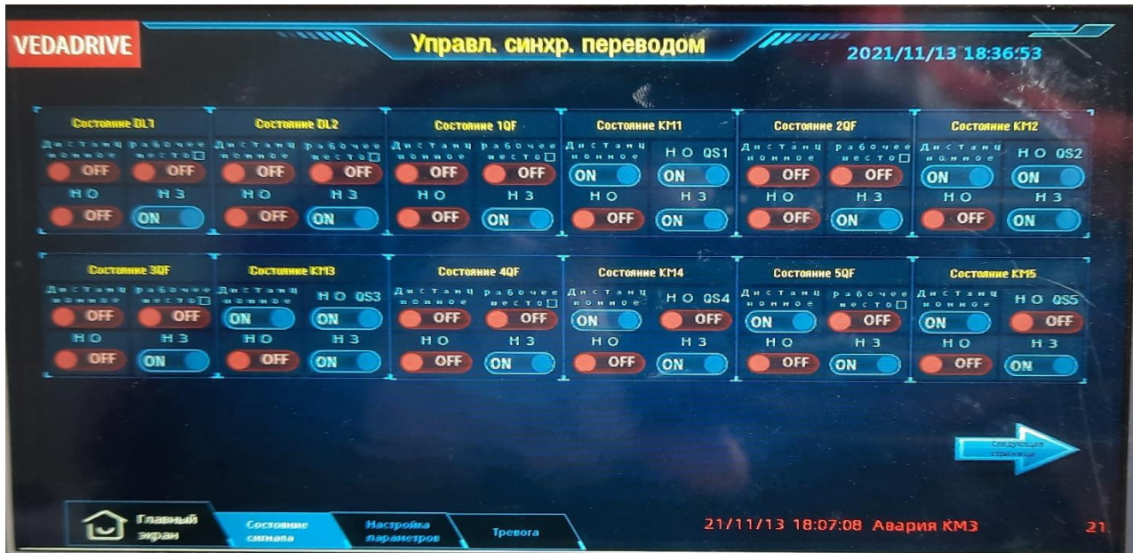
Рис. 6.14 – Окно состояния сигналов системы синхронизации с сетью
